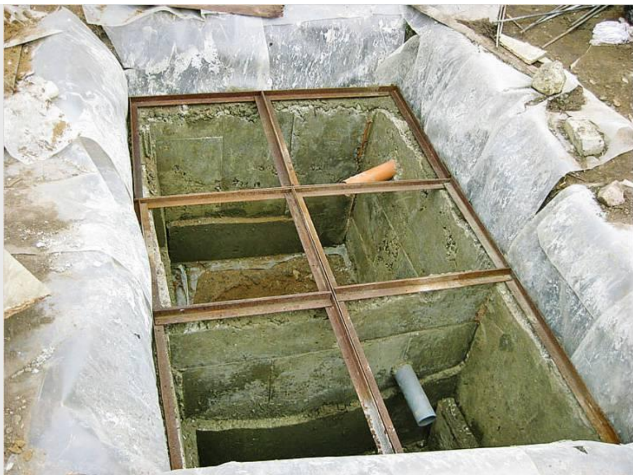
Самостоятельно залитая бетонная конструкция
